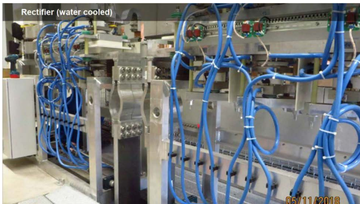
Rectificadores refrigerados por agua.
