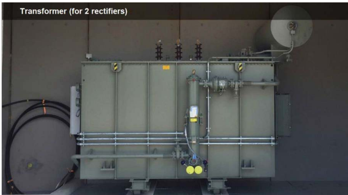
Transformador de la Planta
